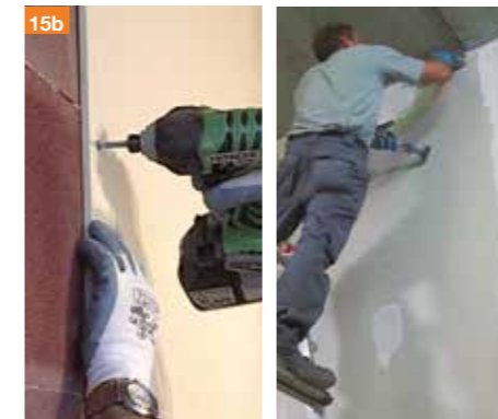
15b. ...e con le viti. Si procede poi con la stuccatura dei giunti.
