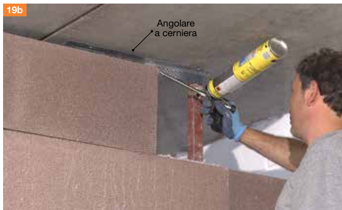
19b. Dispositivo in profilato di acciaio (angolare a cerniera) per l'ancoraggio al soffitto.
