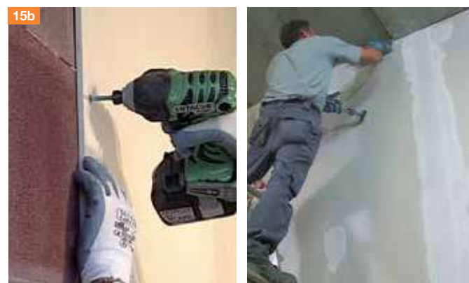
15b. ...e con le viti. Si procede poi con la stuccatura dei giunti.
